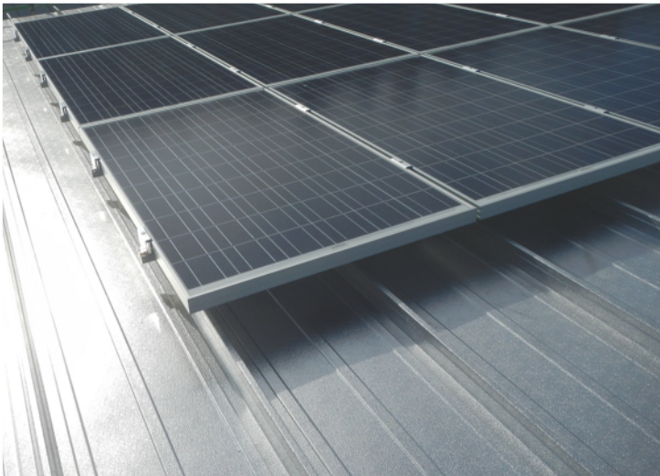
Detailaufnahme der neu errichteten Photovoltaikanlage
